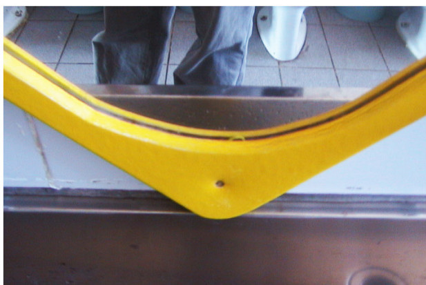
Espelho instalado em cima da pia do banheiro. A água espirra no espelho e cai dentro da moldura de MDF, causando estufamento.
